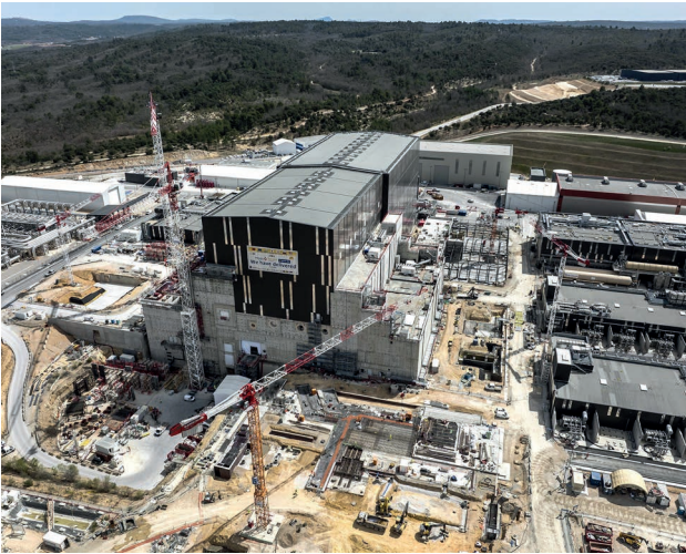
Vogelperspektive der ITER Baustelle in Cadarache (FR). Das zentrale Gebäude besteht aus der Montagehalle und der Tokamak Grube. Bild: © ITER Organization
